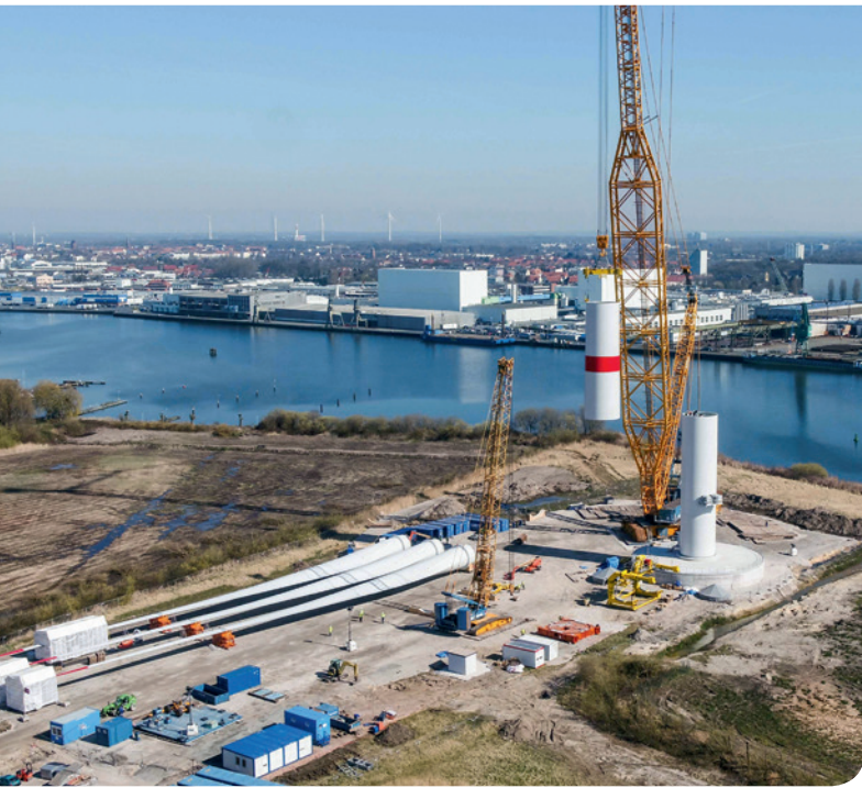
Um gute Zugänglichkeit zu gewährleisten, steht die für den Offshore-Einsatz konzipierte Forschungsanlage an Land. © Adwen
